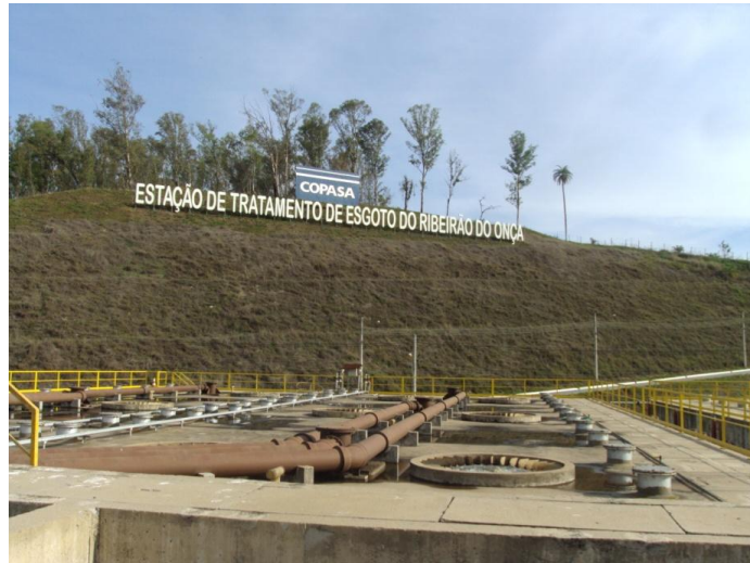
Figura 3. Estação de tratamento de esgoto Ribeirão da Onça – Belo Horizonte.
