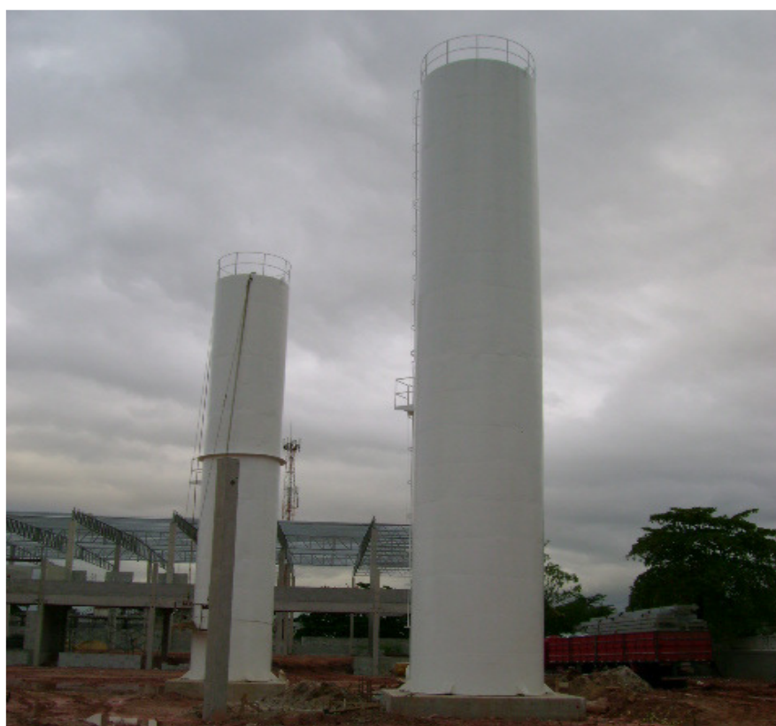
Figura 21 – Reservatórios tubulares para uso de água potável e não potável. Fonte: SGO Construções, 2011.
