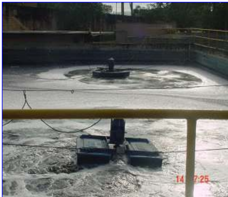
Figura 4.5 – Tanque de Equalização 01
