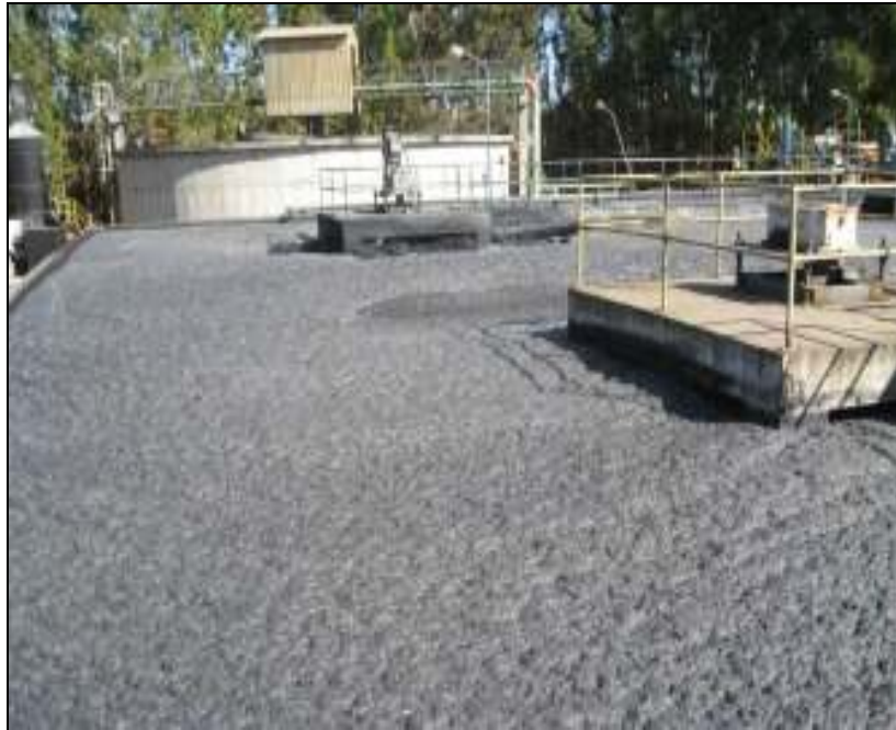
Figura 4.9 – Tanque de Aeração
