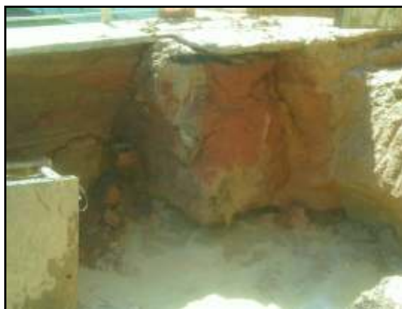
Figura 5.1 – Desmoronamento durante escavação (foto do autor)
