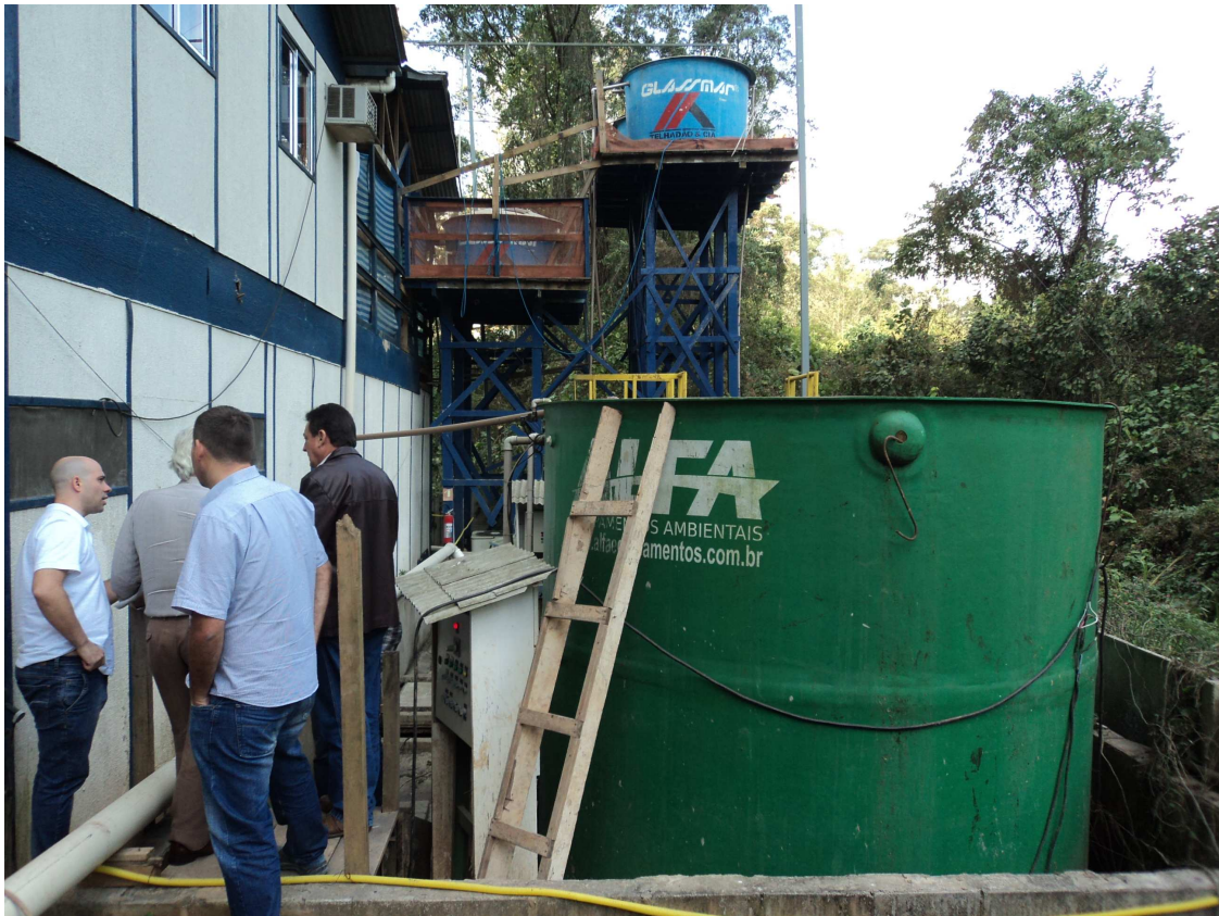
Figura 6 - Sistema de tratamento de efluentes em funcionamento, detalhe das caixas d'água com a água de reuso.
