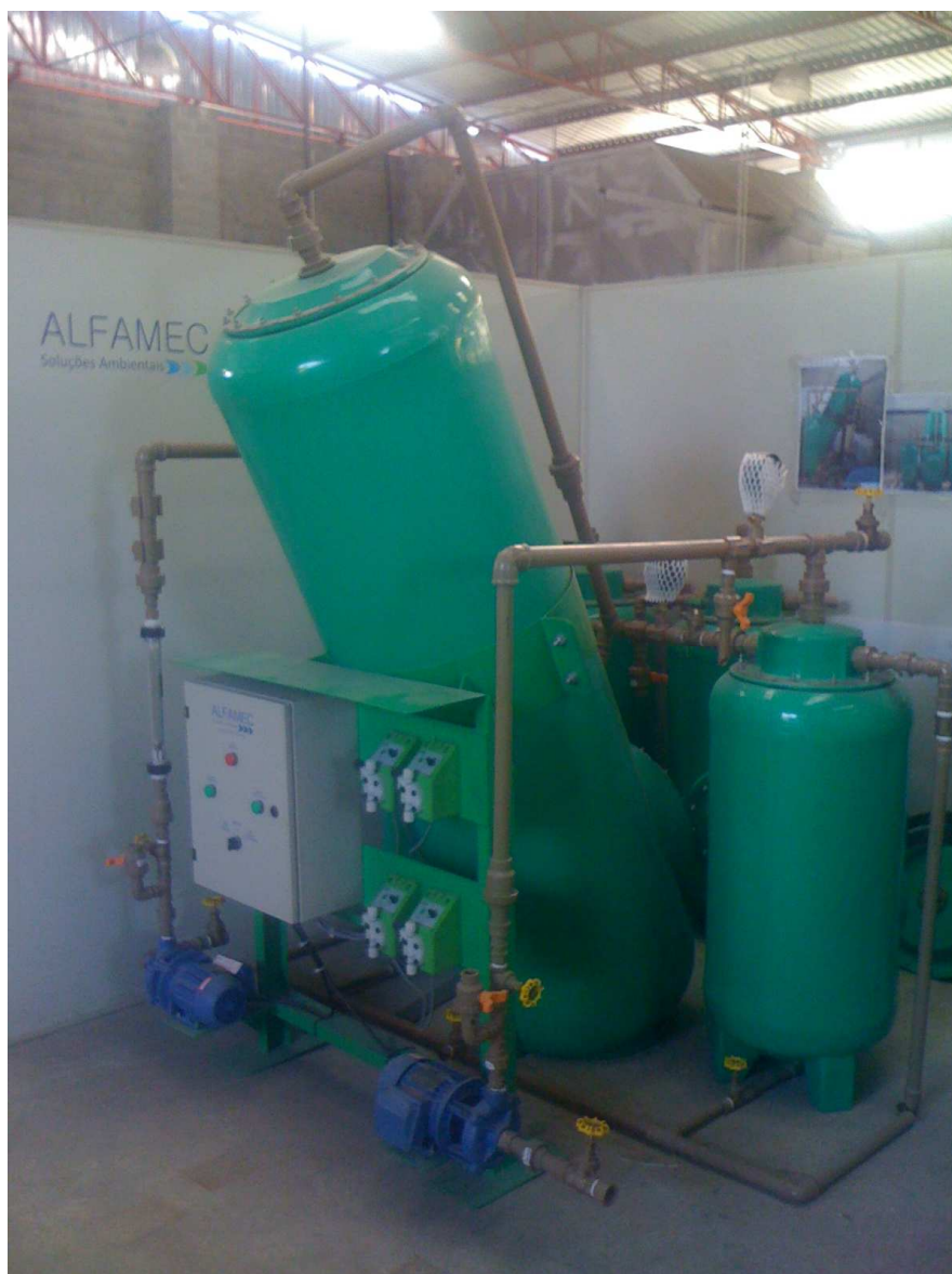
Figura 5 - Unidade de clarificação e desinfecção do tratamento.
