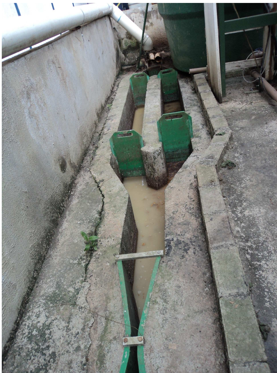
Figura 7 - Tratamento preliminar da estação de tratamento de efluentes.
