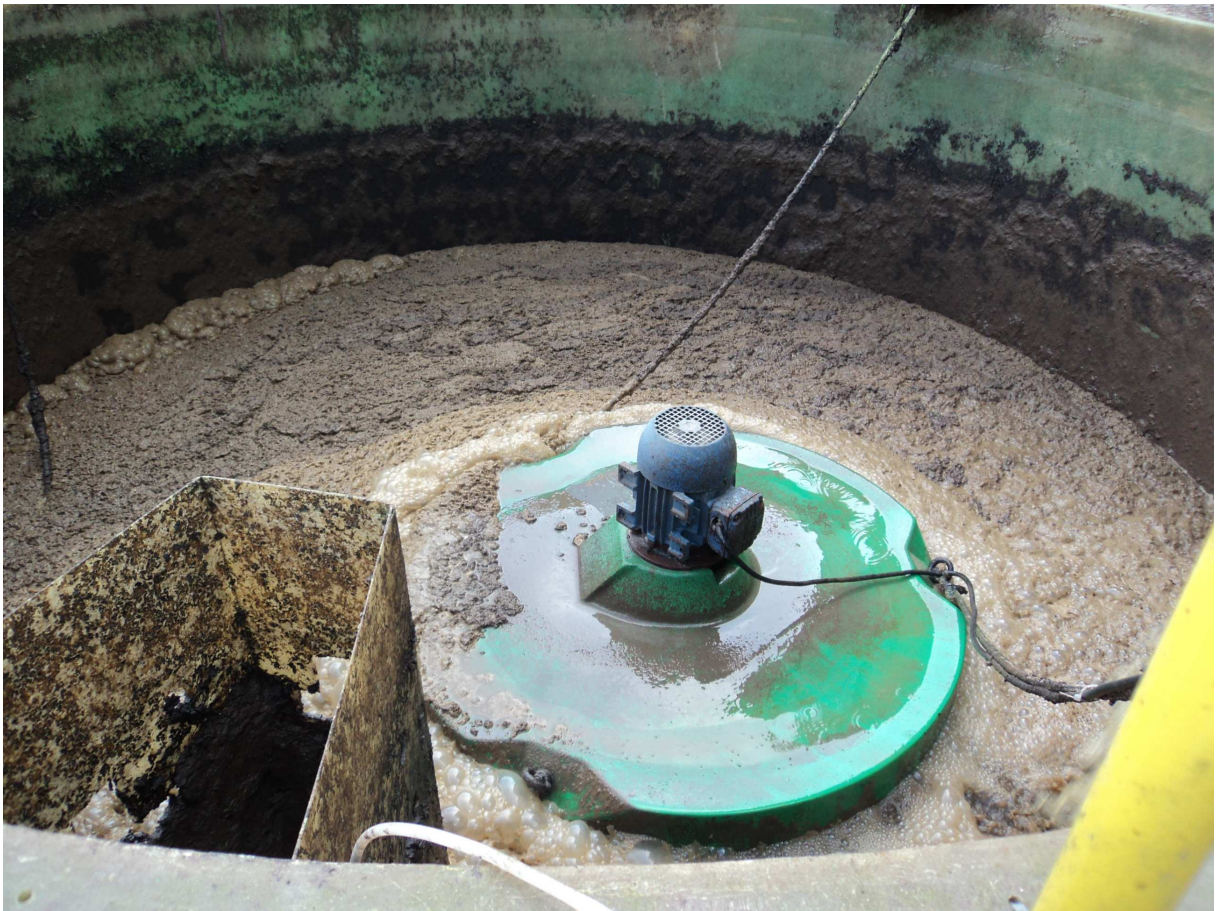
Figura 8 - Detalhe do aerador do reator aeróbio
