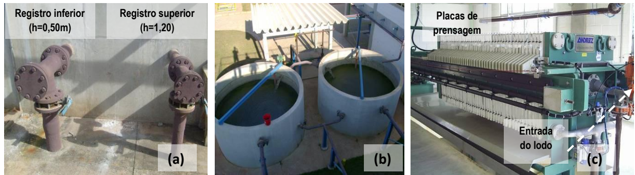
Figura 4.4 - (a) Tubulações de descarte de lodo na lateral dos reatores UASB; (b) Tanques de armazenamento de lodo; (c) filtro prensa
