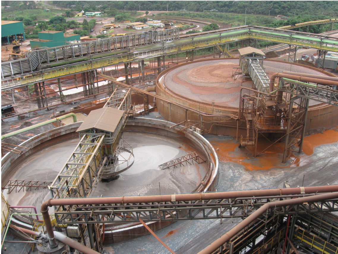
Figura 3.6: Espessadores instalados na Usina de Germano - Samarco (FONSECA,2008)
