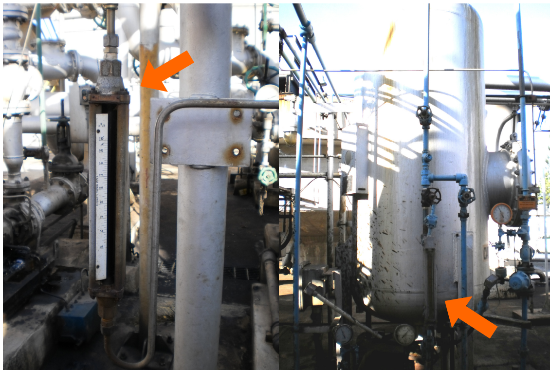
Figura 20. Rotâmetros para indicação da vazão de recirculação de água (esquerda) e de ar (direita) para vaso de pressurização.
