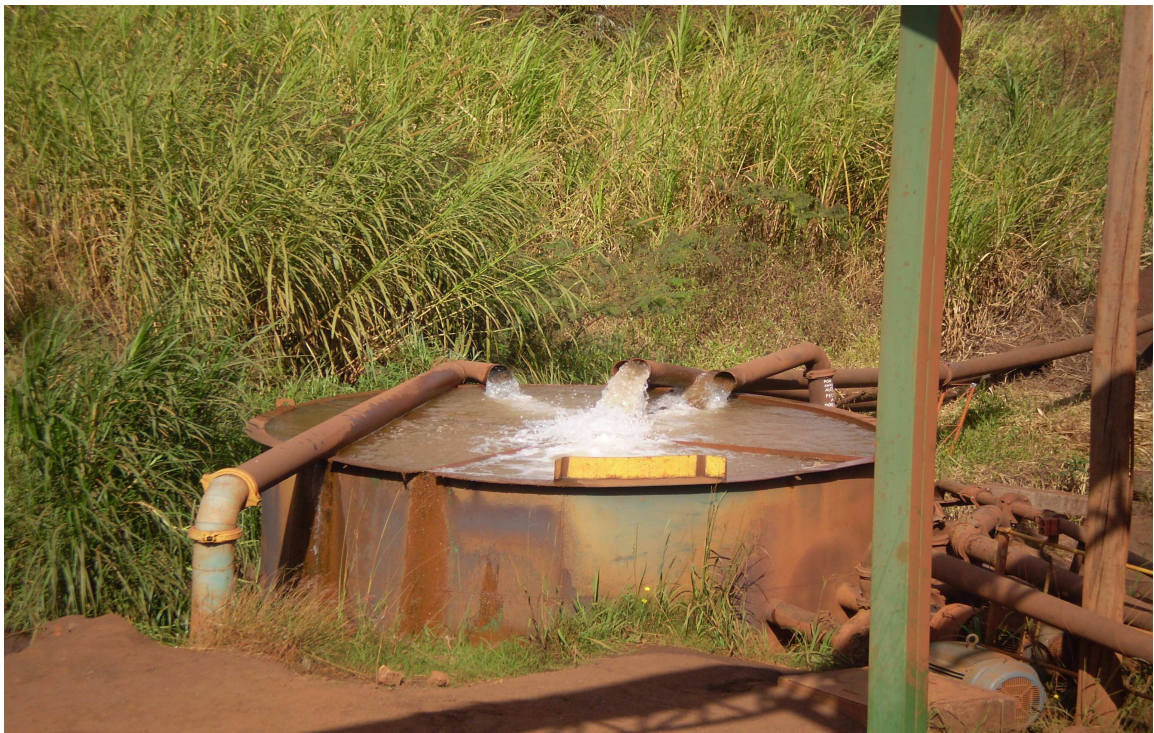
Foto 12: Desperdício de água no tanque de armazenamento (maio/2010).
