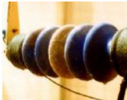
Figura 4.8 - Deterioração de um para-raios devido ao depósito de resíduos em sua superfície
