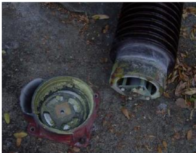
Figura 4.9 - Corrosão das partes metálicas de um para-raios devido à penetração de umidade
