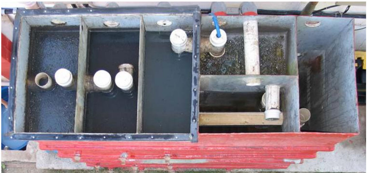
Figura 4.28 – Vista superior de uma estação de tratamento para águas cinzas.
