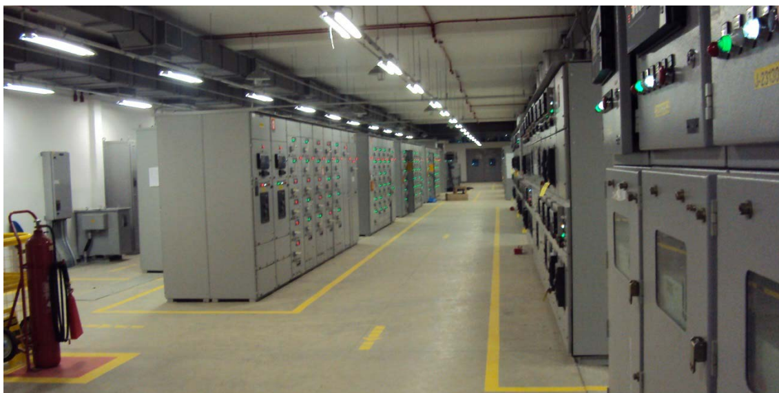
Figura 2.1 - Sala de painéis 1 .
