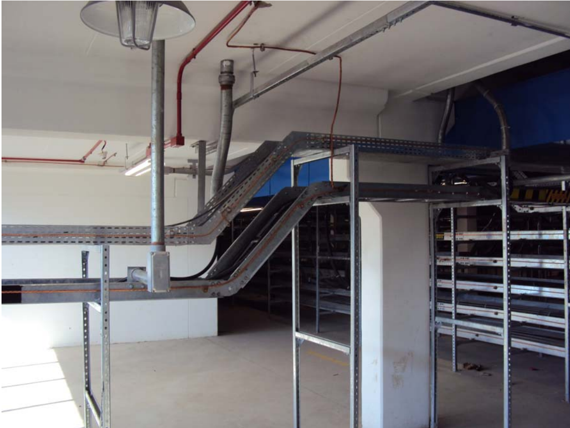
Figura 2.2 - Sala de cabos.
