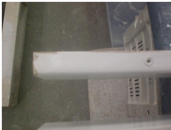
(Figura 9) – Detalhe de uma das peças apresentando o defeito na pintura (descascada).
