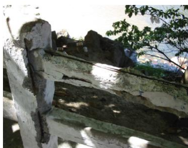
Figura 3.1 – Corrosão química em Mureta (Boa Viagem, Niterói-RJ) (MERÇON et al. , 2004)
