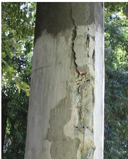
Figura 3.2 – Corrosão química em concreto armado no poste (MERÇON et al. , 2004).
