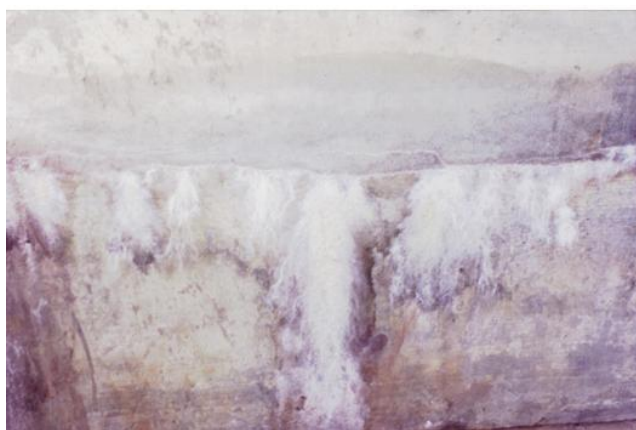
Figura 3.17 – Lixiviação em fissuras de concreto (GENTIL, 2007).
