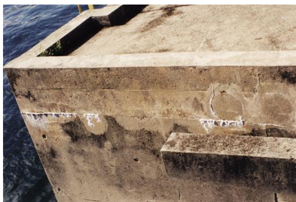
Figura 3.18 – Fissura no concreto com presença de produto de carbonatação (GENTIL, 2007).
