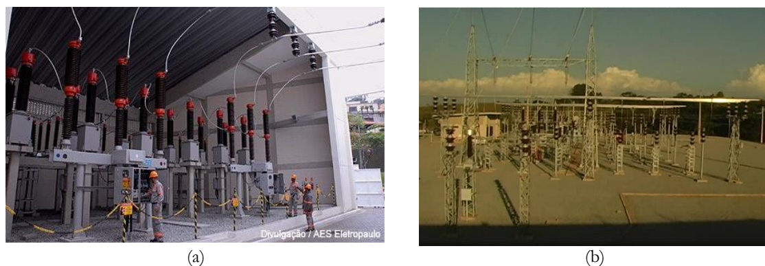
Figura 2.3 Tipos de subestação convencional: SE abrigada (a) e SE desabrigada (b) Fonte: (AES / ELETROPAULO, 2012).
