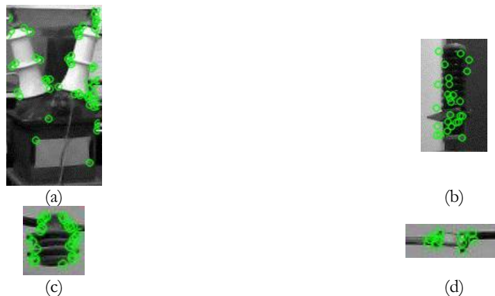
Figura 8.1 Detecção de pontos de interesse: transformador (a), para-raios (b), isolador (c) e conector (d)
