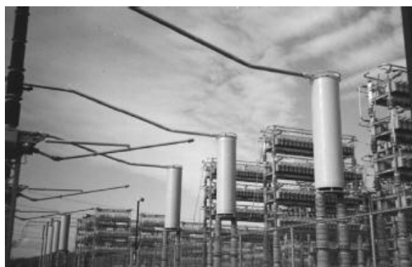
Figura 9. Reatores Associados a Bancos de Capacitores; retirada de [18].
