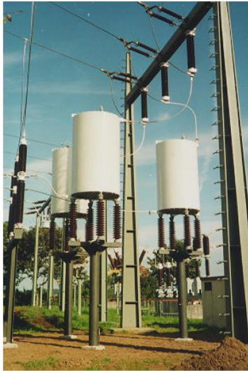
Figura 19. Reatores a seco com núcleo de ar na SE Landsham; retirada de [16].
