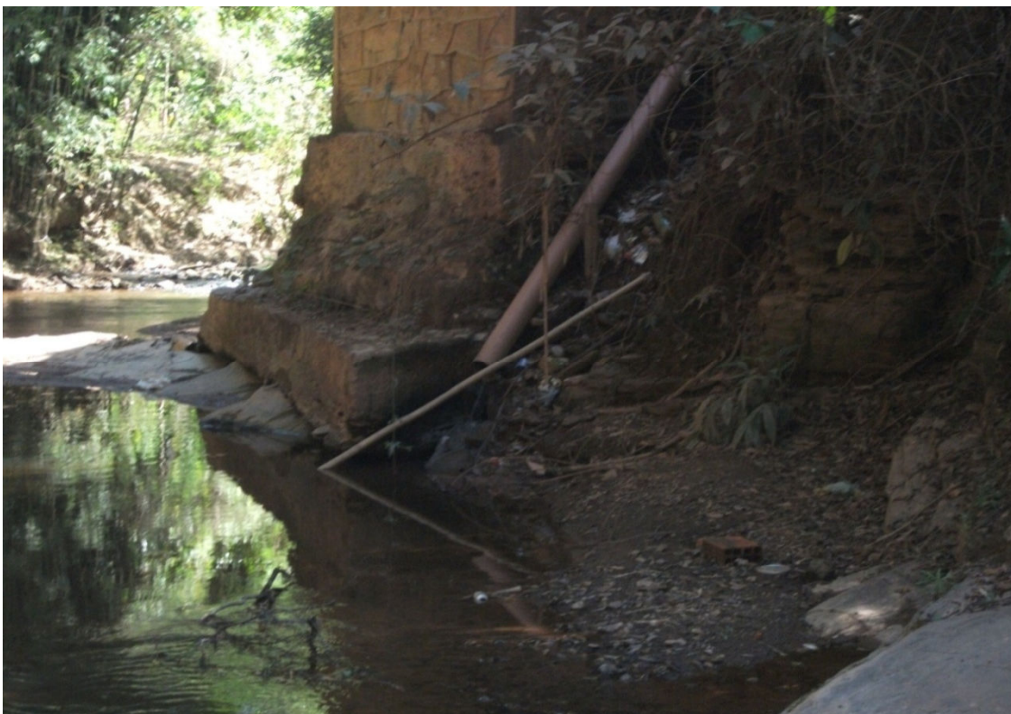
Figura 9: Esgoto sendo despejado no Córrego Cortesia (Outubro de 2012). Autor: Matheus D. Santos
