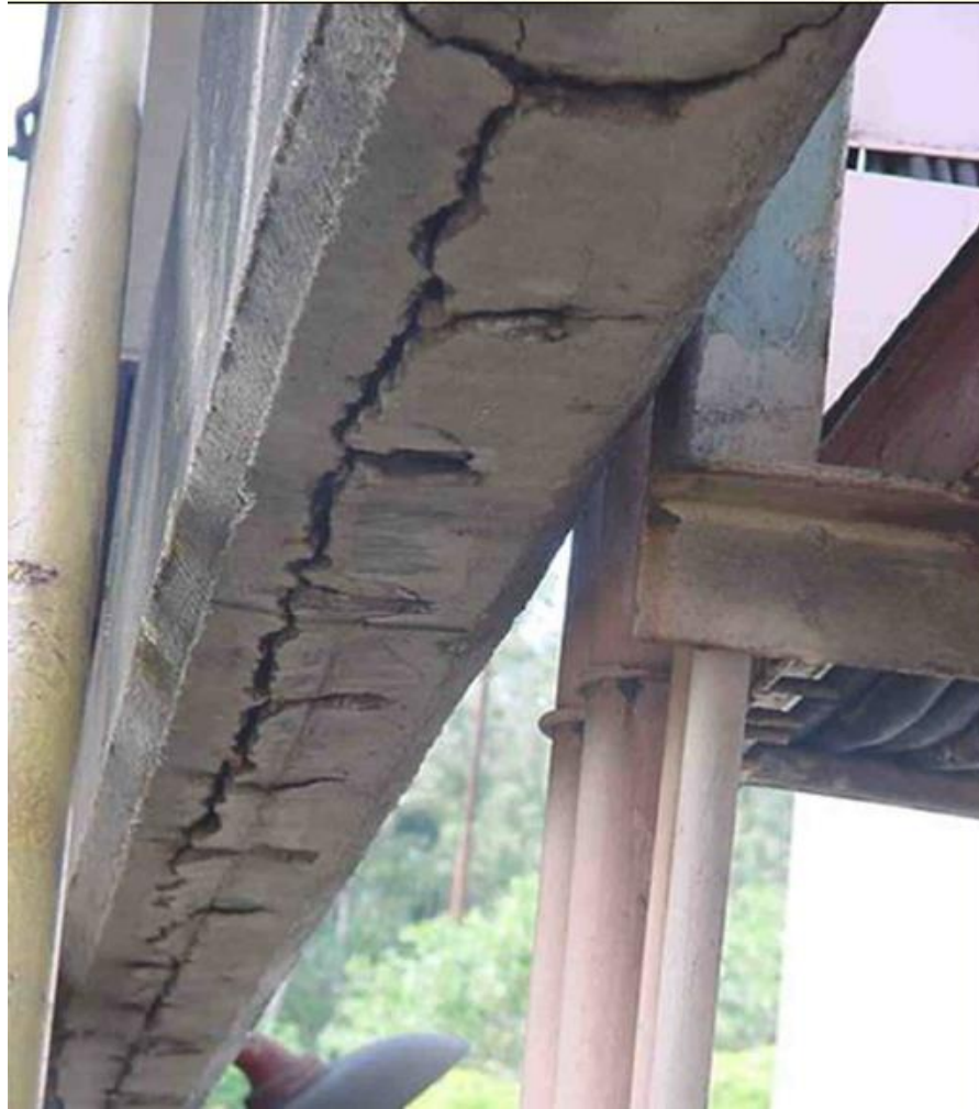
Figura 5 - Aguiar J. – Apostila Mecanismo de Deterioração do Concreto – Desplacamento do concreto devido à expansão dos óxidos gerados pela corrosão.
