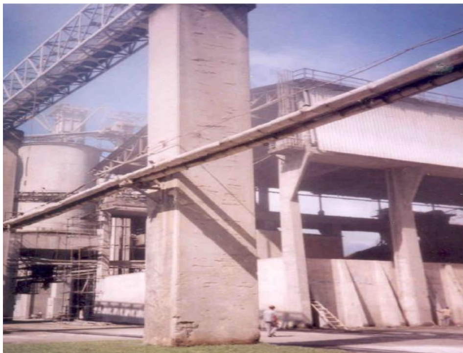
Figura 6 - Aguiar J. – Apostila Mecanismo de Deterioração do Concreto – corrosão generalizada
