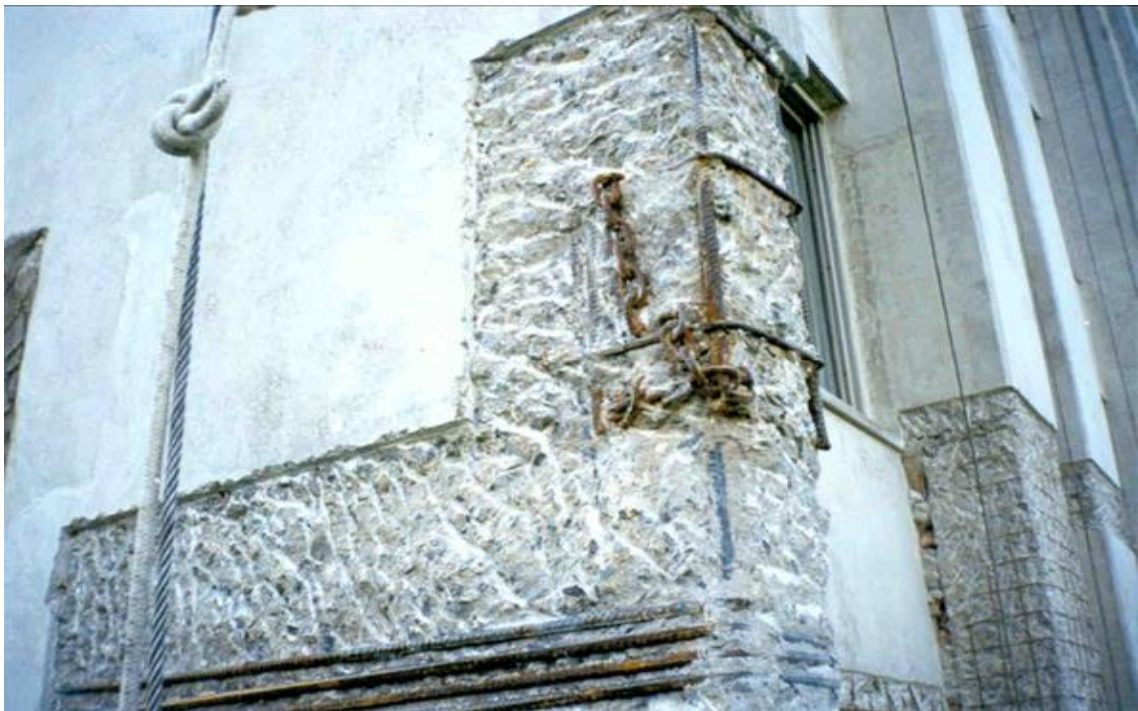
Figura 8 - Aguiar J. – Apostila Mecanismo de Deterioração do Concreto – Corrosão galvânica
