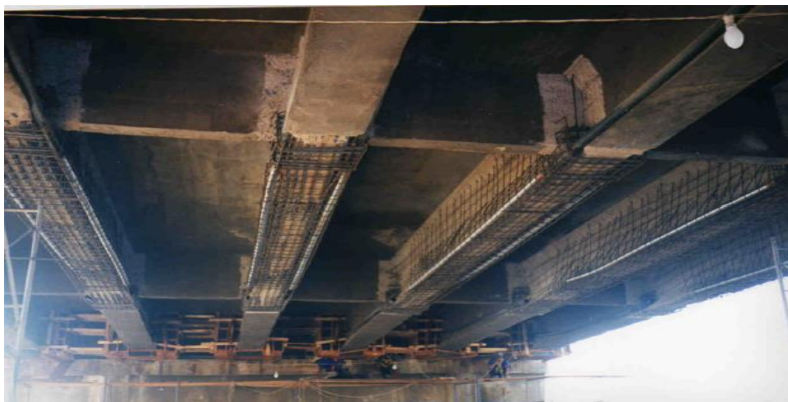
Figura 7 - Aguiar J. – Apostila Mecanismo de Deterioração do Concreto – A figura mostra a corrosão sob tensão em uma viga protendida.
