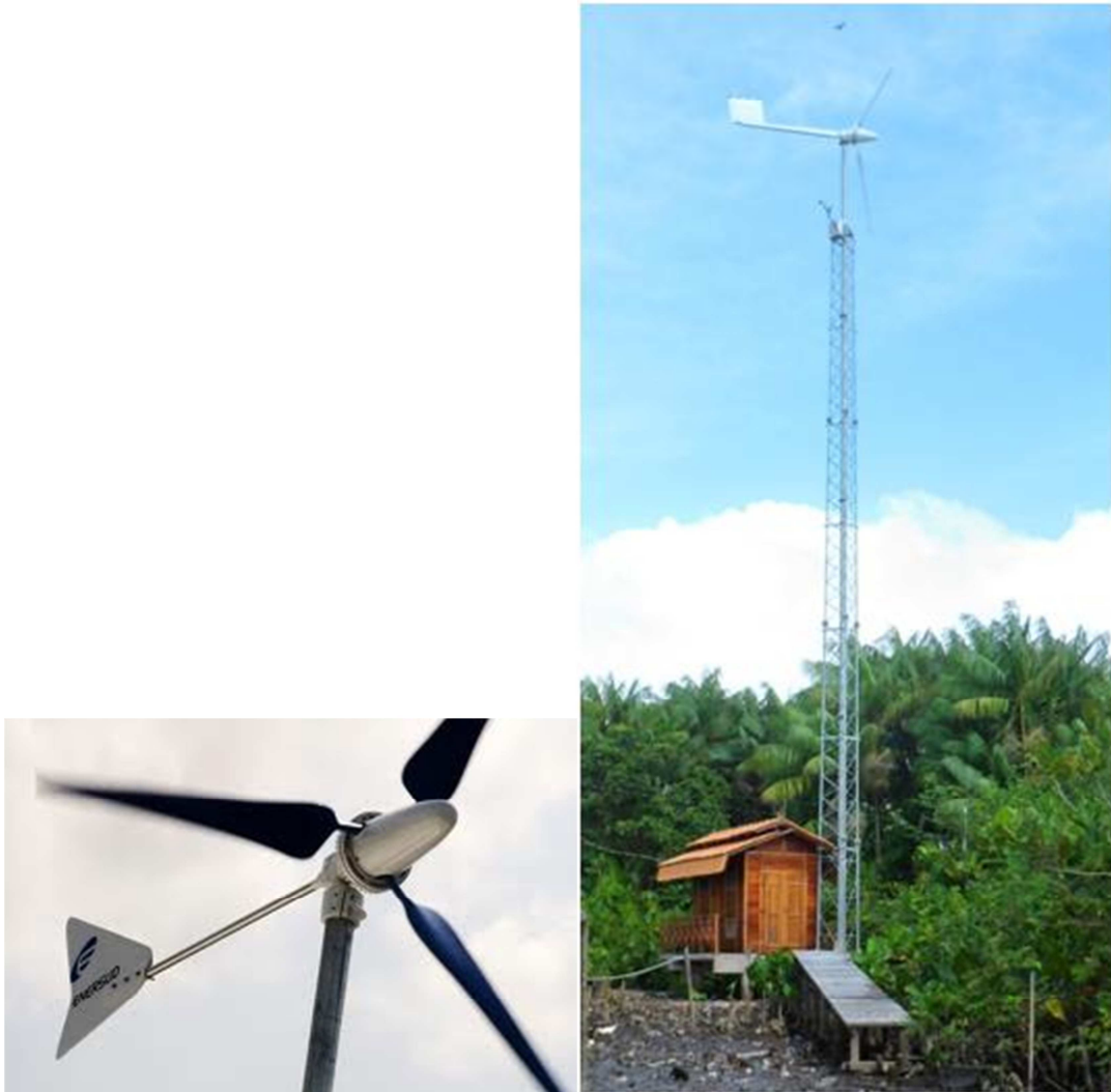
Figura 2.6 – Vistas de Aerogerador de 6 kW Instalado na Região Amazônica do Brasil Fonte: acervo do autor
