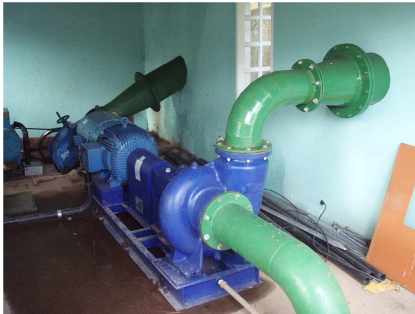
Figura 2.4 – Casa de Força de uma mCH Fonte: [UFLA, 2010]
