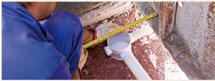
FIGURA 3.6: Tubulação de esgoto posicionada antes da concretagem do piso ou fundação. Fonte: ( http://www.equipededeobra.com.br/construcao-reforma/37/artigo220698-1.asp )
