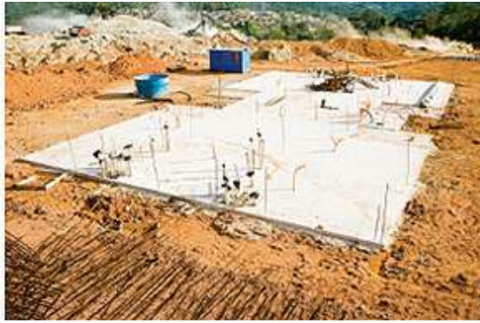
FIGURA 5.2: Fundação de uma edificação tipo radier para paredes de concreto. Fonte: ( http://www.bps.com.br/ibts/news/paredes_concreto.pdf ).
