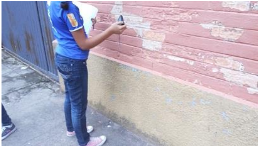
Foto 5 – Captação das imagens externas da escola: paredes descascadas.
