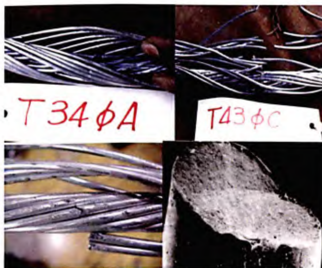
FIGURA 2. 12 – Danos por fadiga em linhas aéreas de transmissão FONTE: FUTADO, 2001
