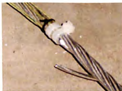
FIGURA 4. 1 – Cabo com 01 fio de Alumínio rompido
