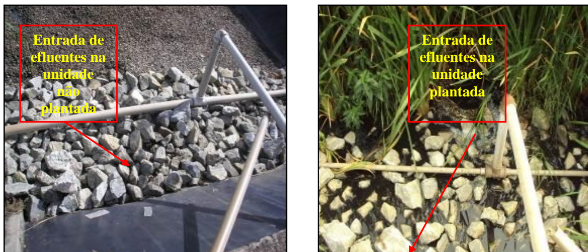
Figura 4.9 - Vista das unidades do SAC, plantada e não plantada, com suas respectivas entradas de efluentes
