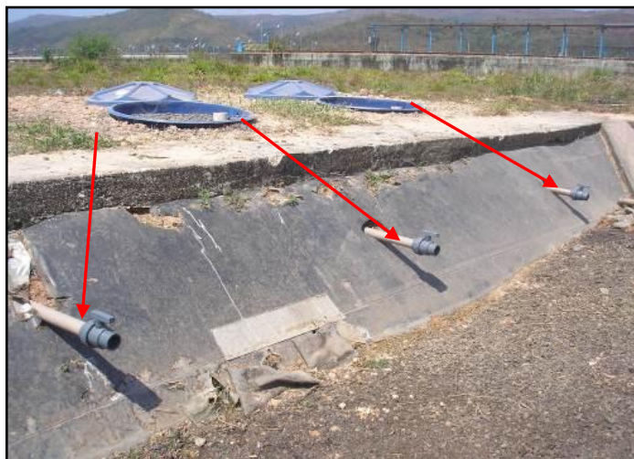
Figura 4.21 - Dispositivo para esvaziamento dos tanques
