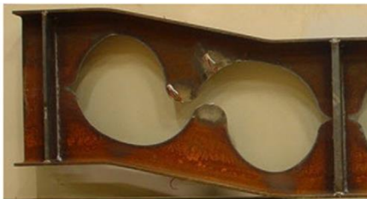
Figura 1.20 – Ruptura da solda entre as aberturas (Tsavdaridis e D’Mello, 2011).
