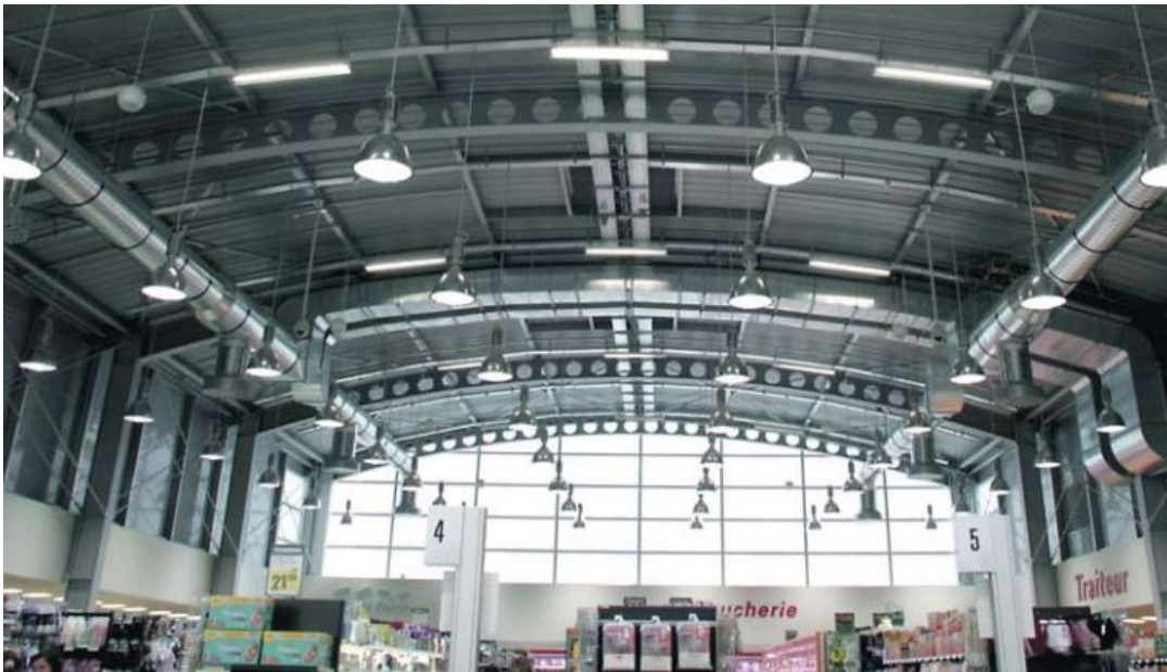
Figura 1.10 – Vigas celulares aplicadas na cobertura de um supermercado (fonte: www.arcelormittal.com – acessado em 11/12/2012).
