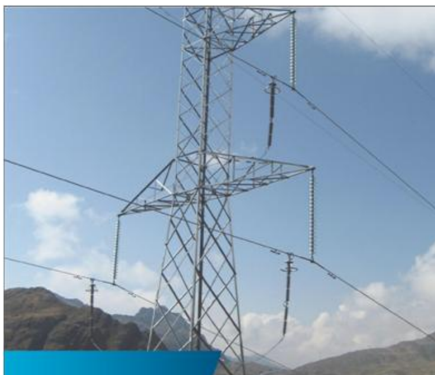
Figura 2.10. Para-raios instalados em paralelo com a cadeia de isoladores de uma linha de 138 kV [Tyco, 2008].
