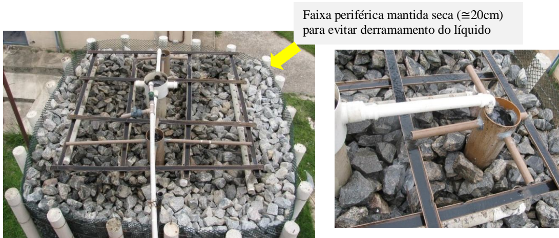
FIGURA 5.5: Sistemas de distribuição afluente do FBPA utilizados nas etapas avaliadas: (a) tubos de PVC perfurados (primeira etapa); (b) canaletas de PVC com vertedores triangulares (segunda etapa).
