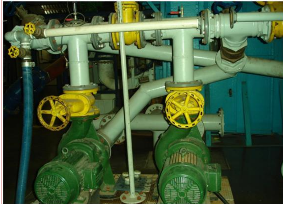
Figura 4.7 – Sistema de bombeamento do aparato
