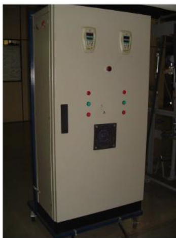
Figura 4.11 – Painel de acionamento das bombas.
