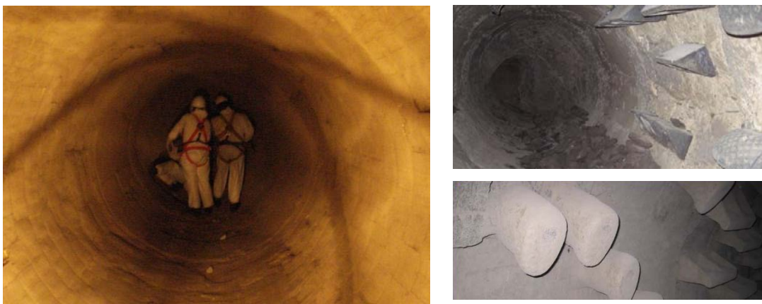
FIGURA 1.5 – Resfriador satélite – Fotos internas – Zona Quente
