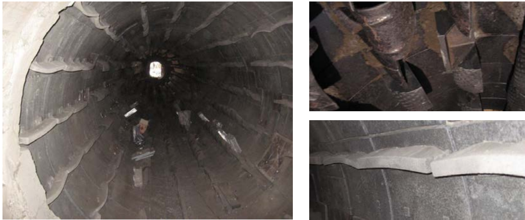
FIGURA 1.6 – Resfriador satélite – Fotos internas – Zona Intermediária
