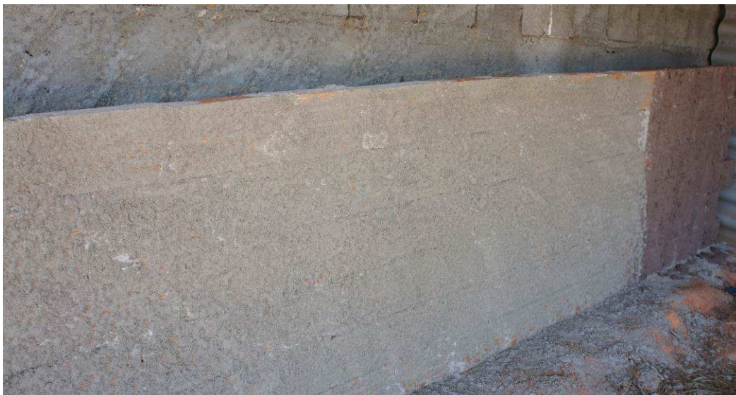
Figura 4.4 – Pannelo construído para a avaliação das argamassas já com argamassa de chapisco aplicada.
