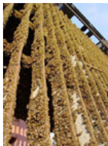
FIGURA 1.3 - Detalhe da incrustação na grade de tomada d'água de usina hidrelétrica.
