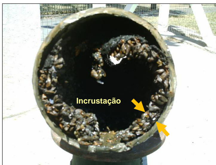
FIGURA 3.2 - Exemplo de tubulação infestada pelo mexilhão dourado, com destaque para a relação entre a espessura da camada de mexilhões e o diâmetro original da tubulação.
