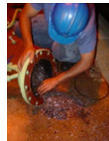
FIGURA 1.4 - Limpeza de filtro tipo hidrociclone.
