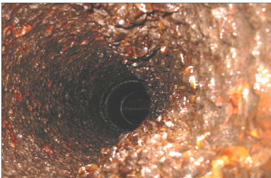
FIGURA 1.5 - Vista do interior de adutora infestada por L. fortunei .
