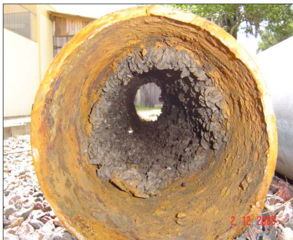
FIGURA 3.8 - Vista de tubulação infestada pelo Mexilhão Dourado.
