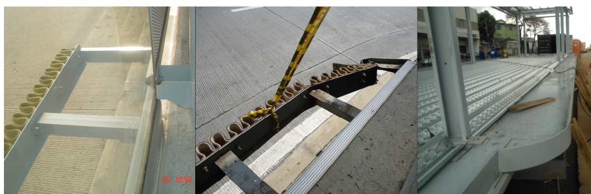
Figura 4.33 – Estruturas dos estribos adotados no BRT de Cali (novo à esquerda e danificado ao meio) e no BRT MOVE (direita)
