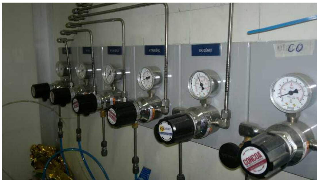
Figura 3.12 – Válvulas reguladoras de pressão dos gases de calibração.
