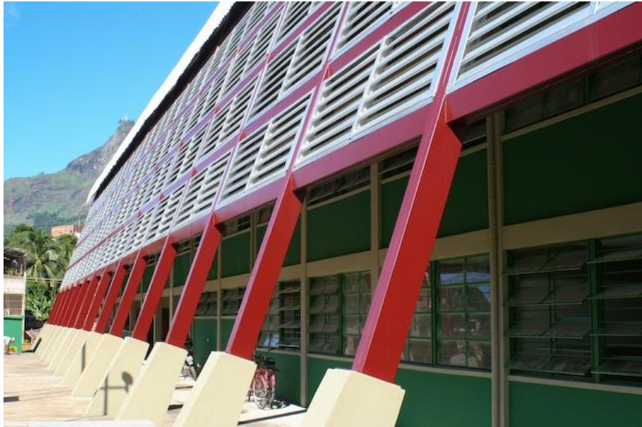
Figura 5: Escola Padrão 3 Pavimentos, E.E. Jardim Ipê, Governador Valadares, MG Fonte: DEOP/MG – outubro/2012
