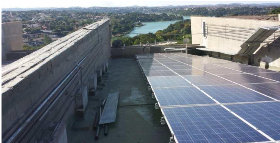
Figura 7 - Pannel solar da USF-MINEIRÃO. Fonte: CEMIG DISTRIBUIÇÃO
