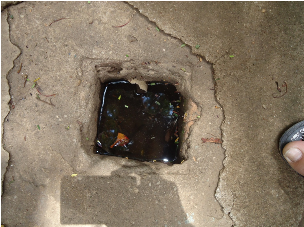
Local contendo água parada, descoberto por aluno.
