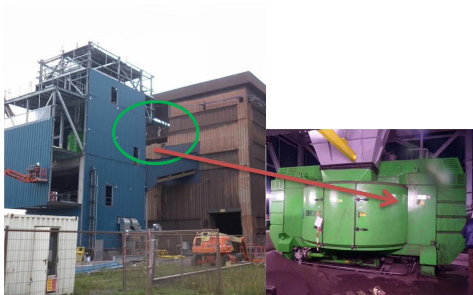
Figura 3.40 – Fotografia da instalação da Sinterização número 2 da Arcelor Mittal Gent. Fonte: LUDIVINE et al (2014).
