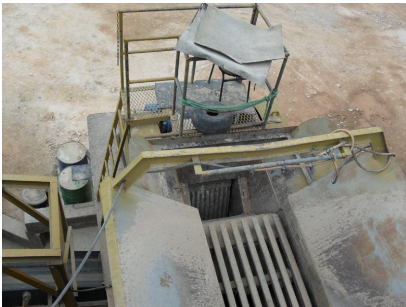
FOTO 6: Britador primário da usina de reciclagem da BR 040.
