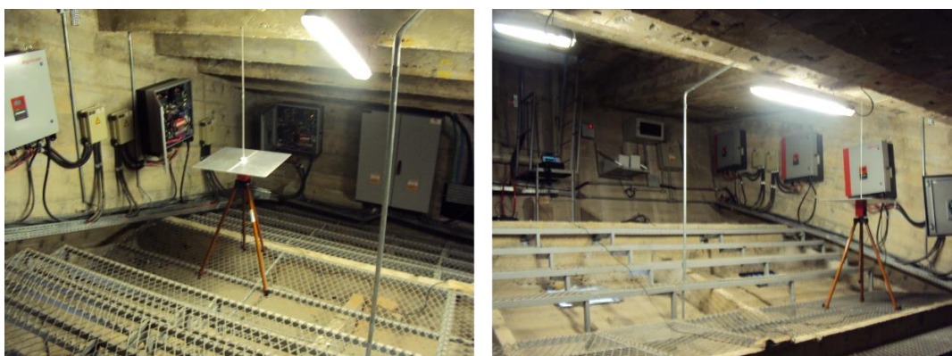
Figura 31. Medição na sala dos inversores.
