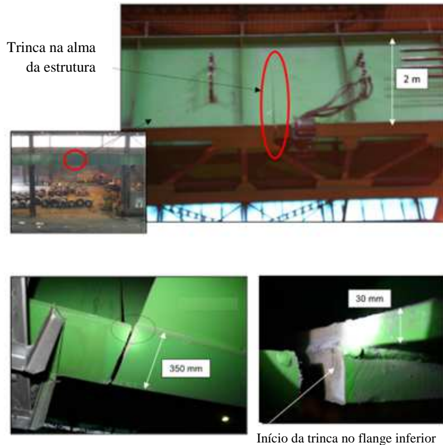
FIGURA 2.18- Falha em viga de rolamento siderúrgica FONTE: Adaptado de PELAYO, RODRIGUEZ, CANTELI, 2015
