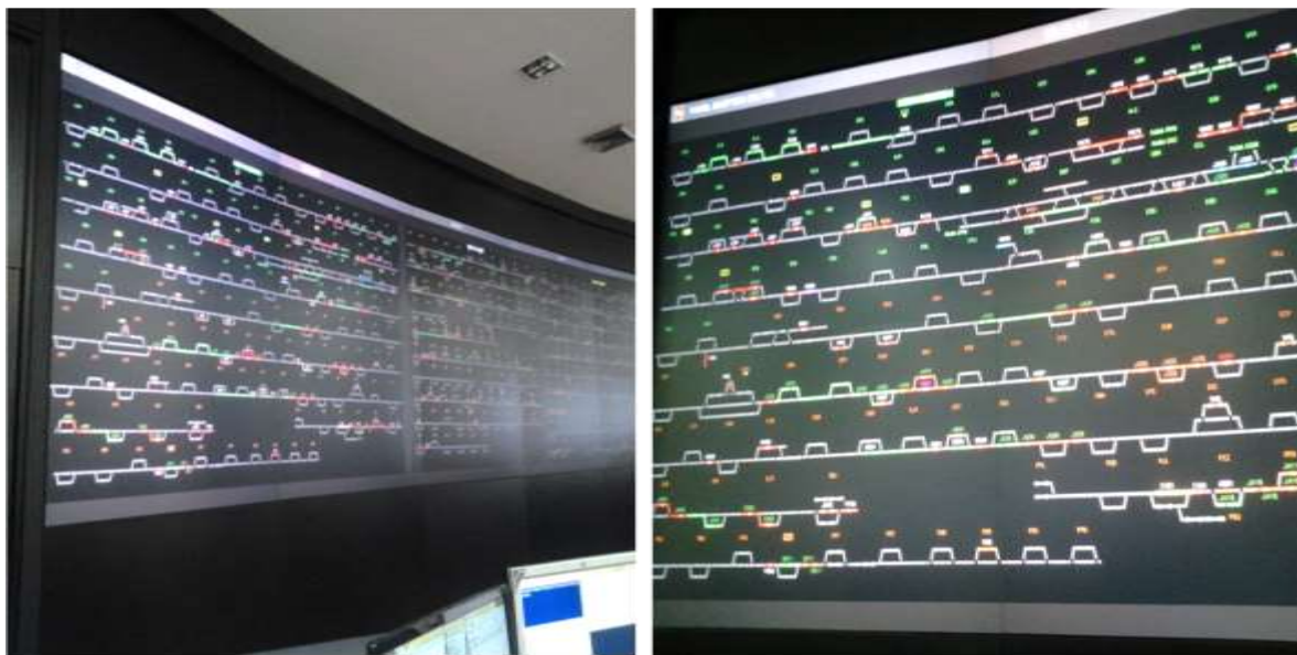
Figura 5 – Painel sinóptico supervisão circulação
