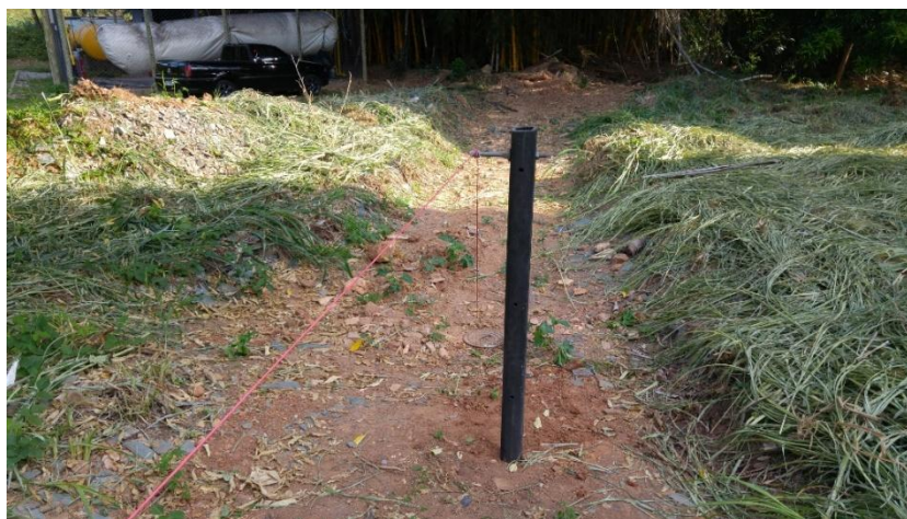
Fig. 5.9 – Terminação da linha aérea utilizada no caso C, evidenciando a conexão ao segundo trecho da malha de aterramento.
