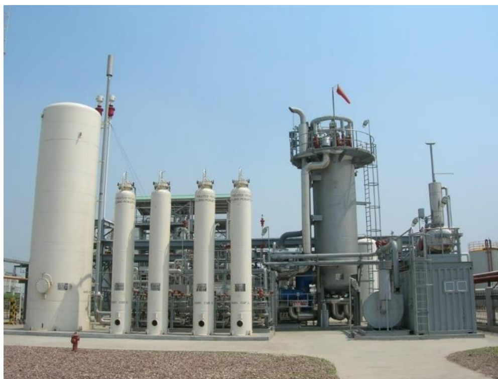
Figura 7 – Equipamento de PSA em uma planta de geração de hidrogênio. FONTE: CALORIC, 2015.
