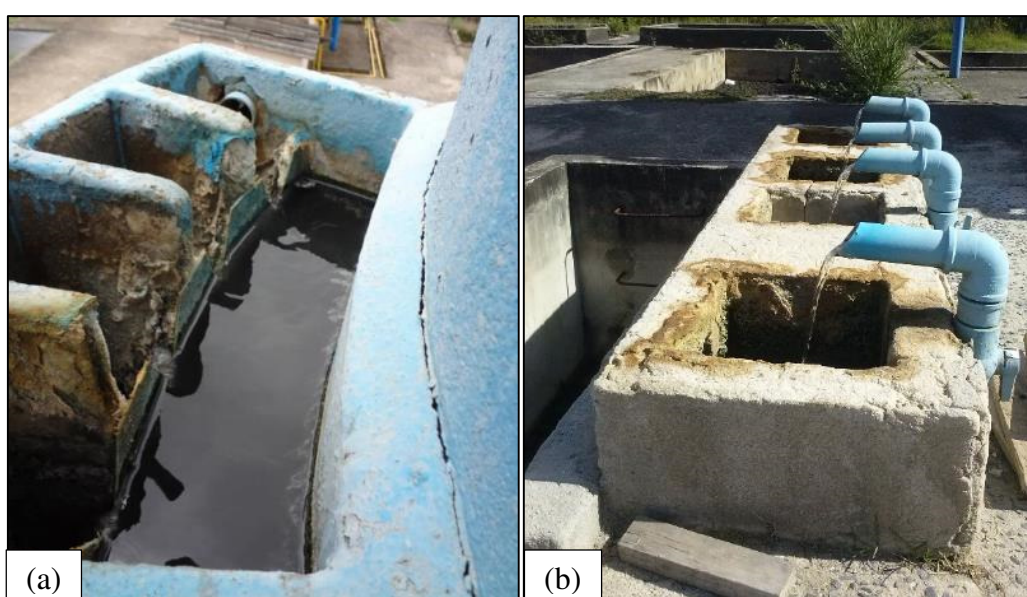
FIGURA 4.3: Sistema de distribuição do afluente, após saída do reator UASB no CePTS-UFMG/COPASA: (a) caixa de equalização de vazão após o UASB, com destaque para os vertedores e (b) caixas de distribuição.
