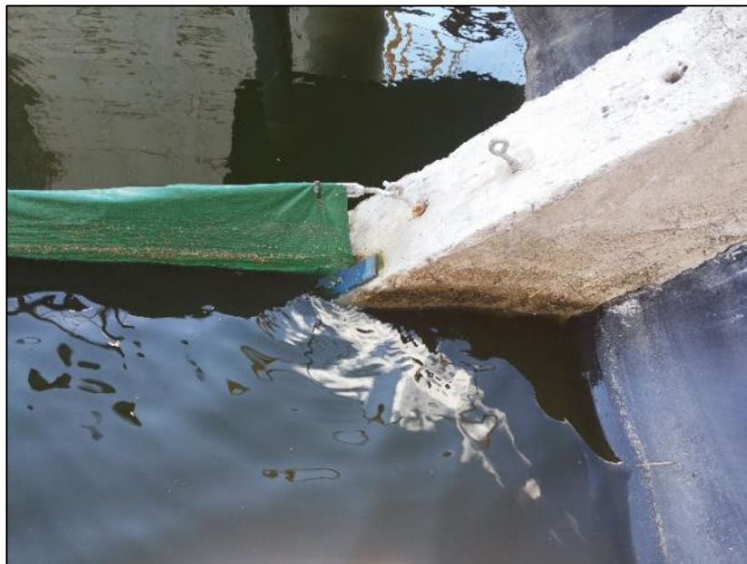
FIGURA 5.50: Detalhe do local de fixação de uma das chicanas da lagoa 2 no talude - CePTS UFMG/COPASA.
