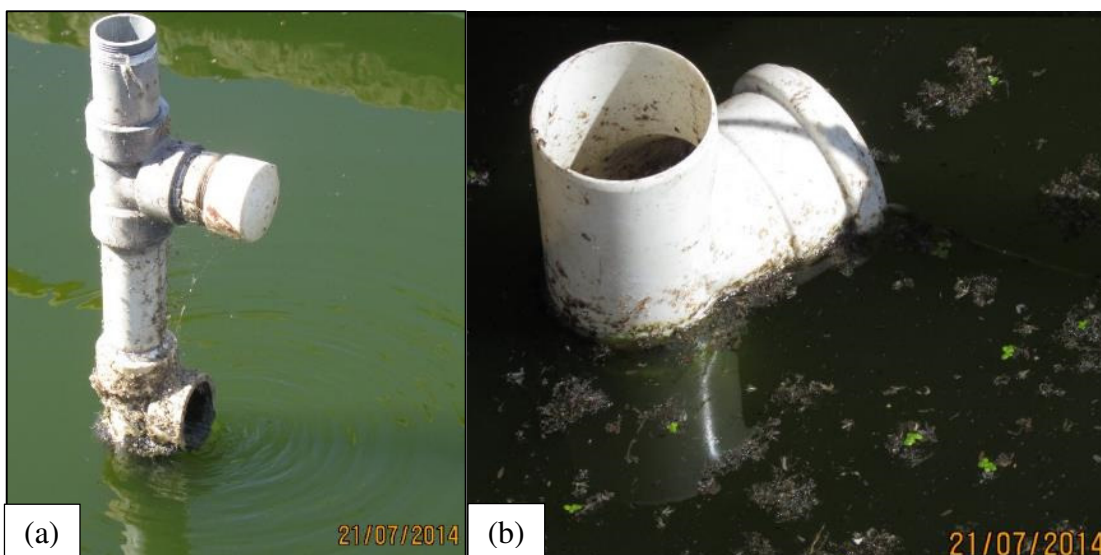
FIGURA 4.12: Vista dos dispositivos de entrada e saída na lagoa 2, fase 2 – CePTS UFMG/COPASA: (a) entrada e (b) saída.
