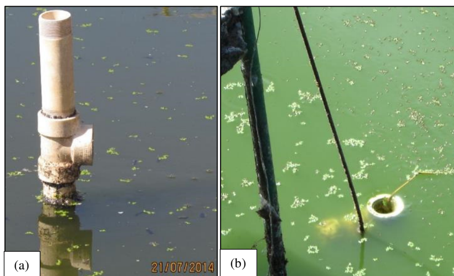
FIGURA 4.5: Vista dos dispositivos de entrada e saída na lagoa 1 – CePTS UFMG/COPASA: (a) entrada e (b) saída.
