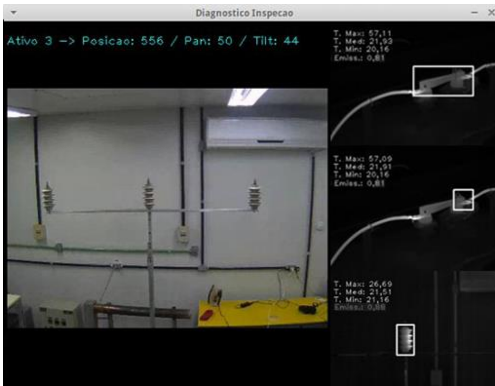
Figura 8.11 – Terceiro ponto de inspeção, focando no para-raios central.
