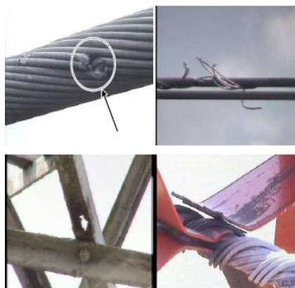
Figura 5.6 – Cabos partidos, corrosão e quebra na estrutura captadas pelo LineScout durante uma inspeção em campo. Fonte: (POULIOT, RICHARD e MONTAMBAULT, 2015).
