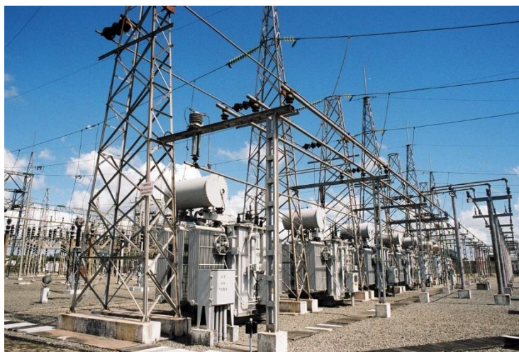
Figura 2.2 – Subestação Muiraquitã, localizada na cidade de Santarém – PA.
