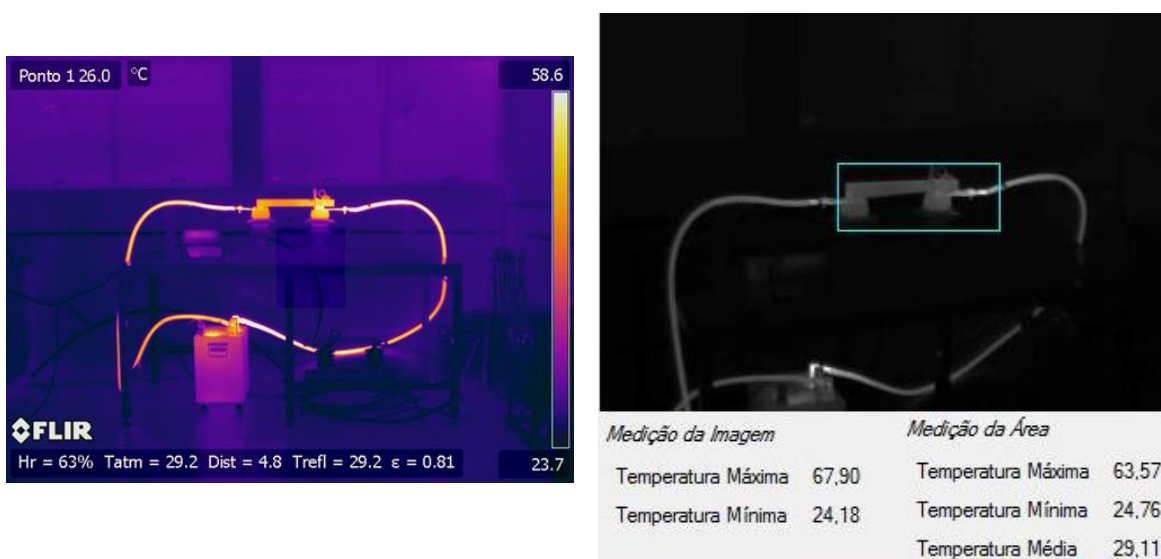
Figura 8.3 - Imagens da chave seccionadora nova registradas da posição 2. À esquerda, a imagem registrada pela SC660 e à direita, as imagens registradas pela A315.
