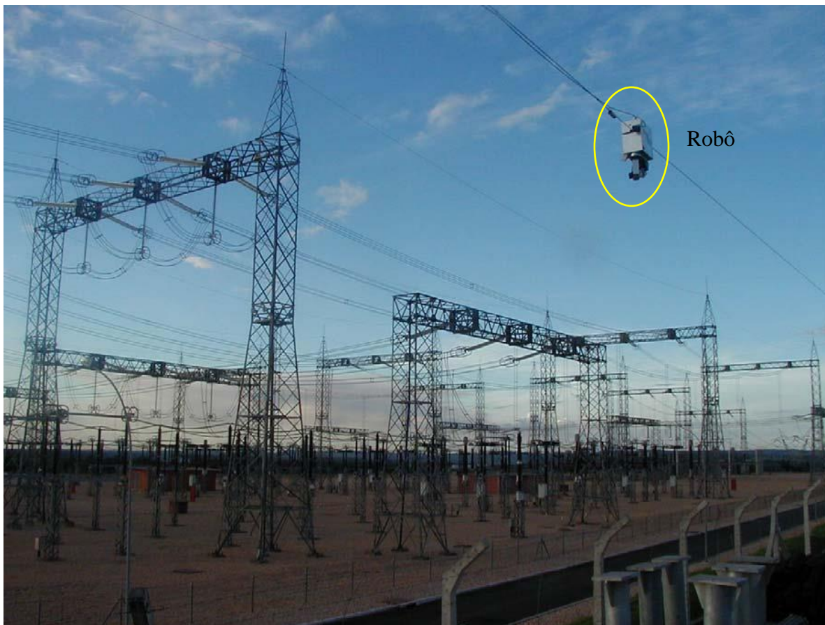
Figura 5.9 – Robô desenvolvido por Pinto (2008) se movendo sobre os cabos de aço instalados na subestação.
