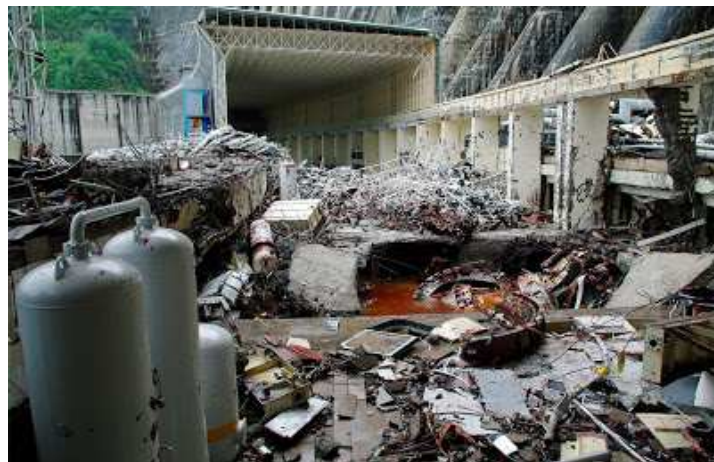
FIGURA 26 – Casa de força após o acidente FONTE: MAESTRI, 2016
