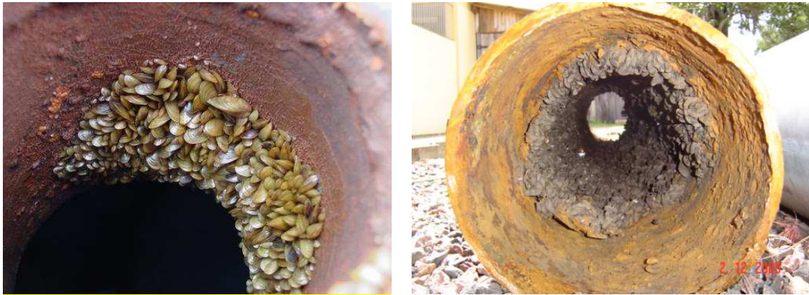
FIGURA 28 – Conduto forçado Infestado pelo mexilhão-dourado FONTE: Esquerda RODRIGO DE FILLIPO (Foto), Direita CORSAN, 2006
