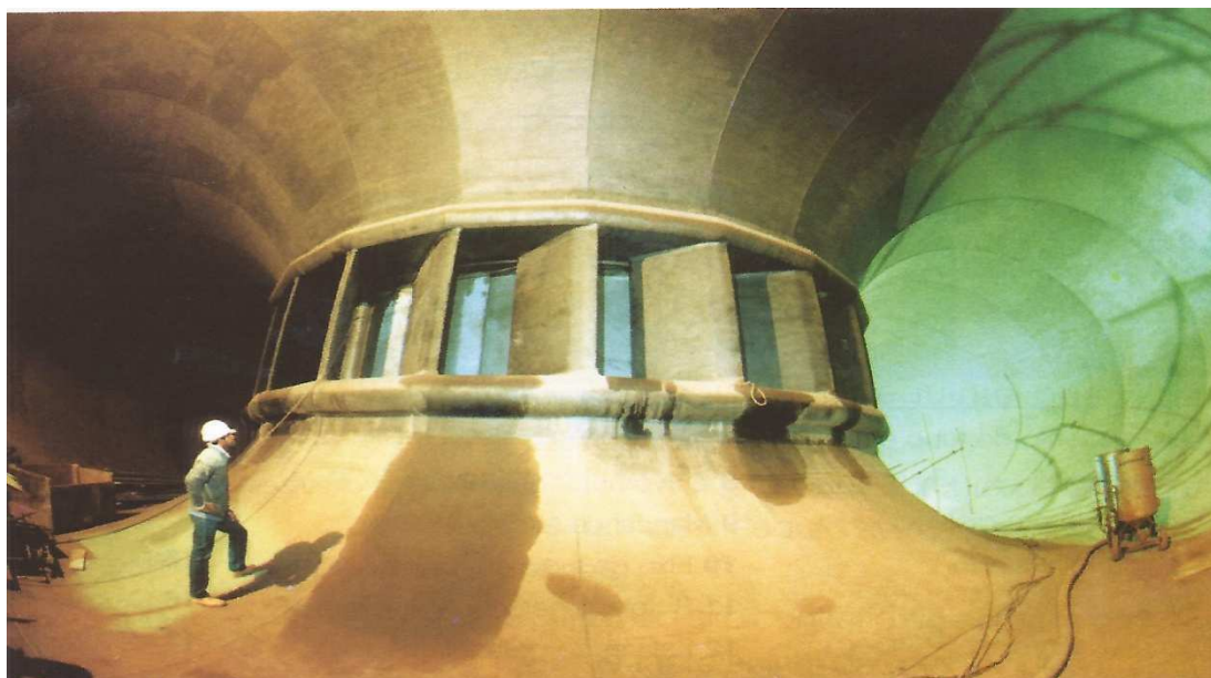
FIGURA 9 – Interior da caixa espiral e pré-distribuidor FONTE: ITAIPU, 2009, P. 12.3
