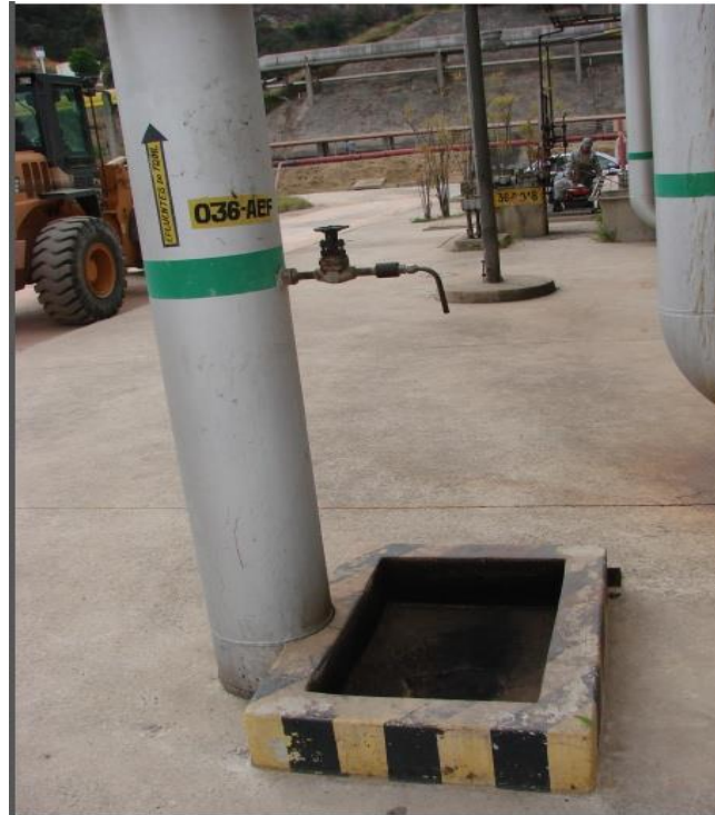
FIGURA 8.28: Ponto de Amostragem do Efluente.
