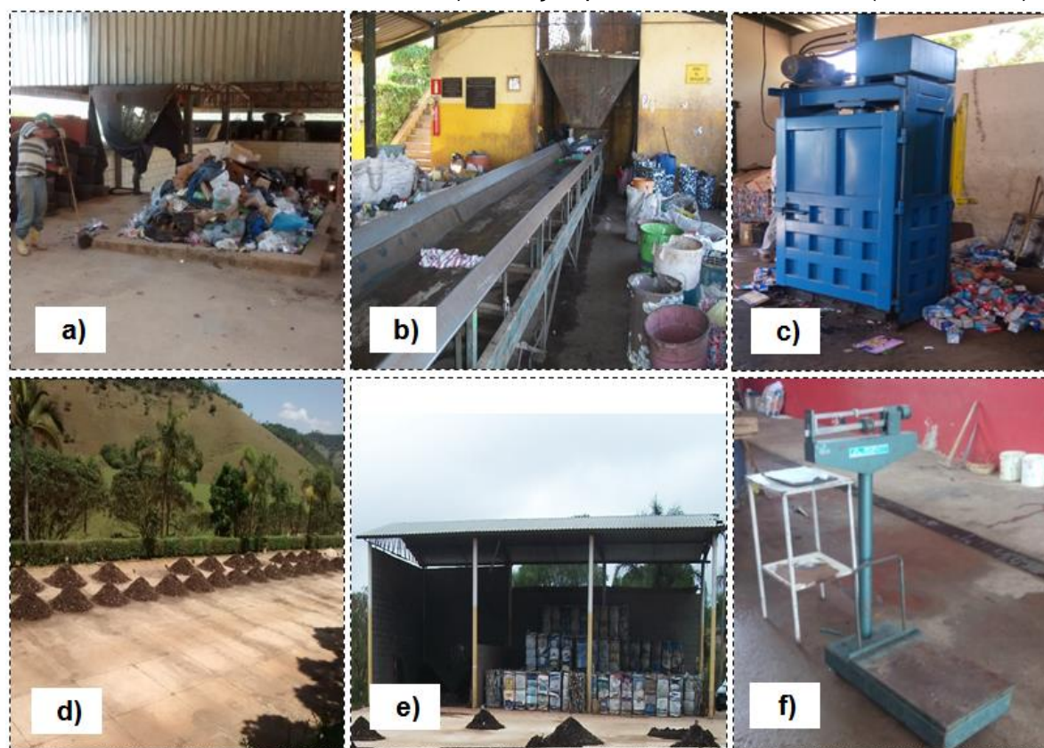
Figura 4.3 – a) Fosso para descarga dos RS; b) Área de triagem dos RS com esteira de catação; c) Prensa hidráulica típica; d) pátio de compostagem impermeabilizado e) área para armazenamento dos recicláveis e f) balança típica utilizada nas UTCs (ano de 2016)
