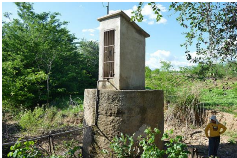
Figura 5.10 - Poço amazonas que integra o sistema de abastecimento de água
