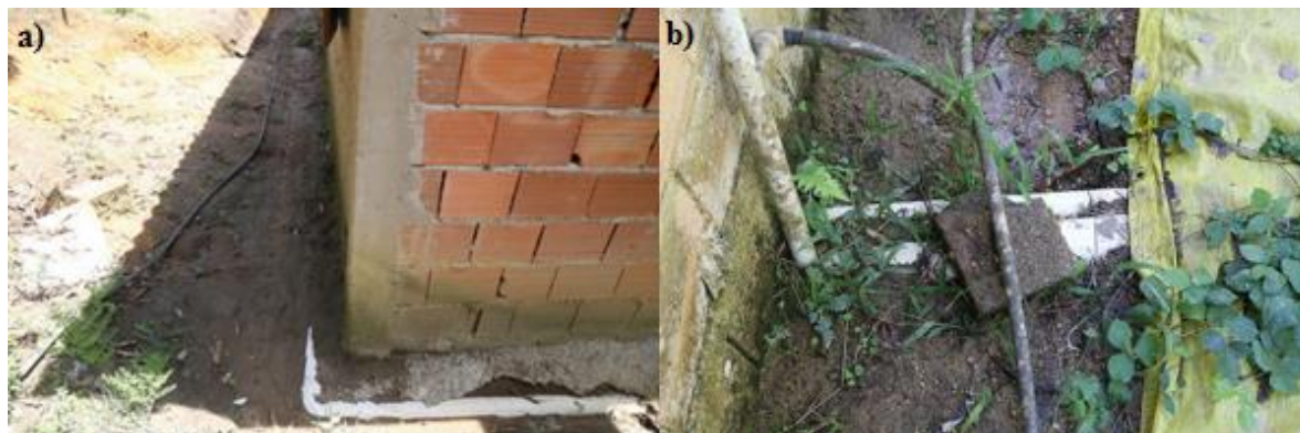
Figura 5.32 - Mangueiras que compõem a solução de abastecimento de água instaladas próximas à tubulações de esgotamento sanitário
