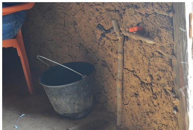
Figura 5.11 - Ponto de água dentro do domicílio
