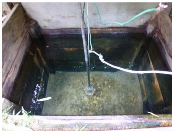
Figura 5.4 - Captação de água em nascente
