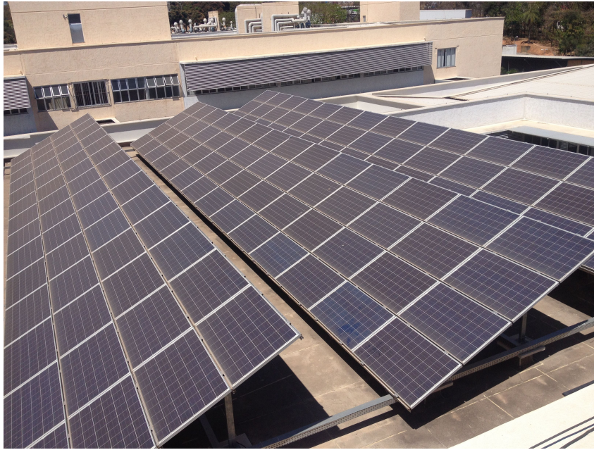
Figura 17 – Visão geral dos módulos fotovoltaicos.
