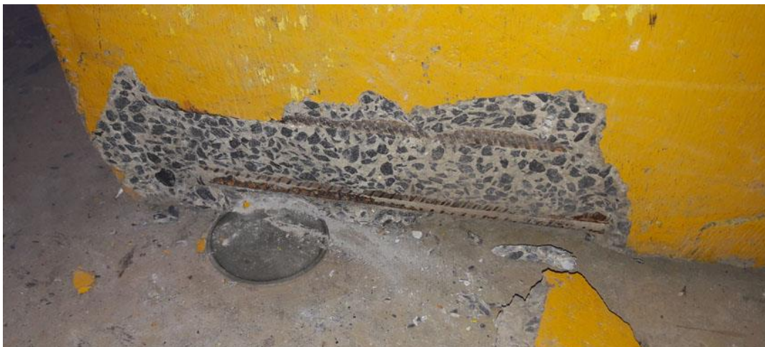
Figura 3.60 – Ruptura localizada do bloco de apoio
